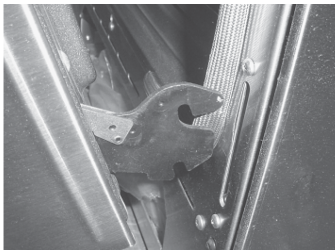
Photo D. Charnières enlevées du four.
